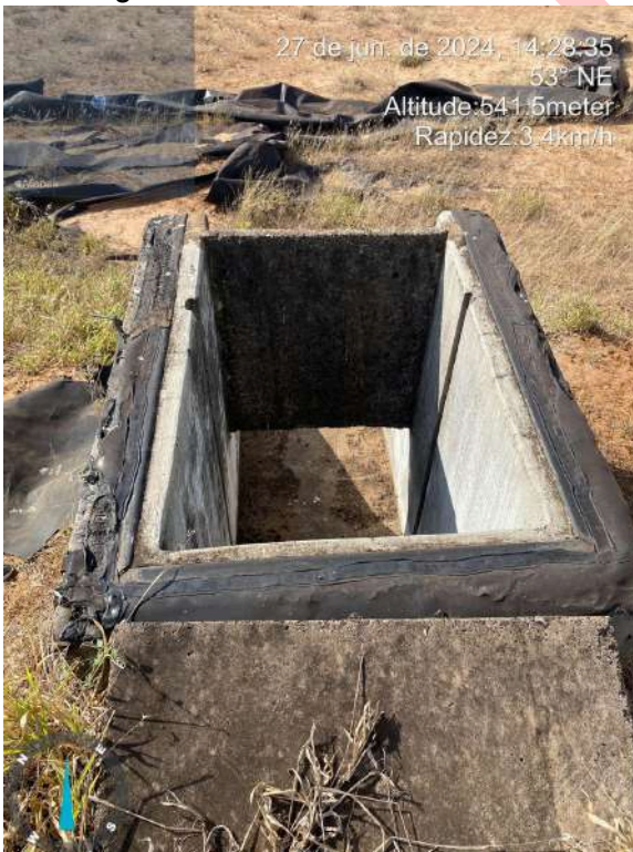
Figura 141: Estrutura da ETE 2.
