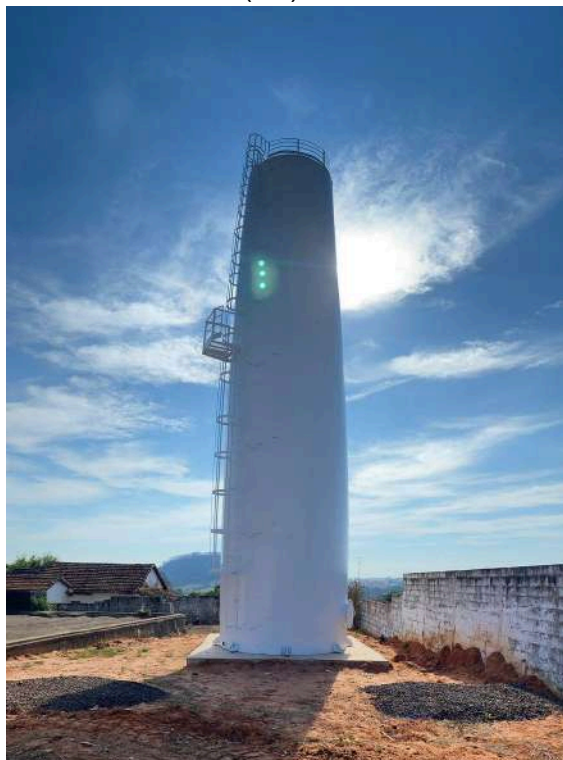
Figura 63: Reservatório elevado metálico (R2).
