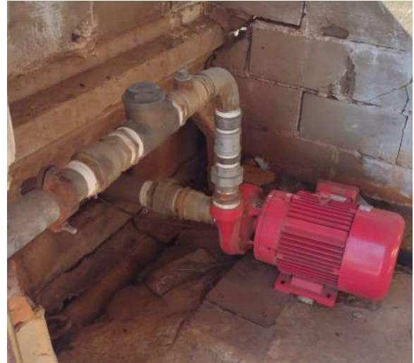
Figura 70: Bomba de abastecimento.
