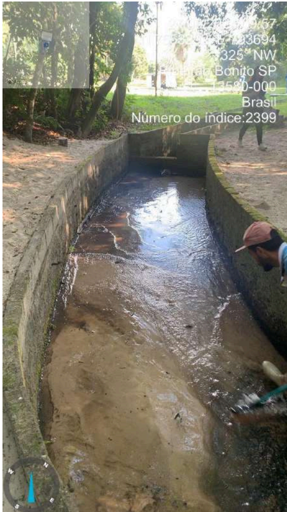
Figura 50: Limpeza manual do sistema.
