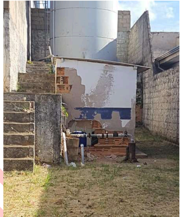
Figura 128: Poço (P11) Reservatório (R12).
