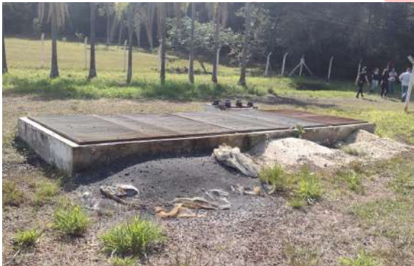
Figura 82: Sistema de tratamento d'água (Filtração).
