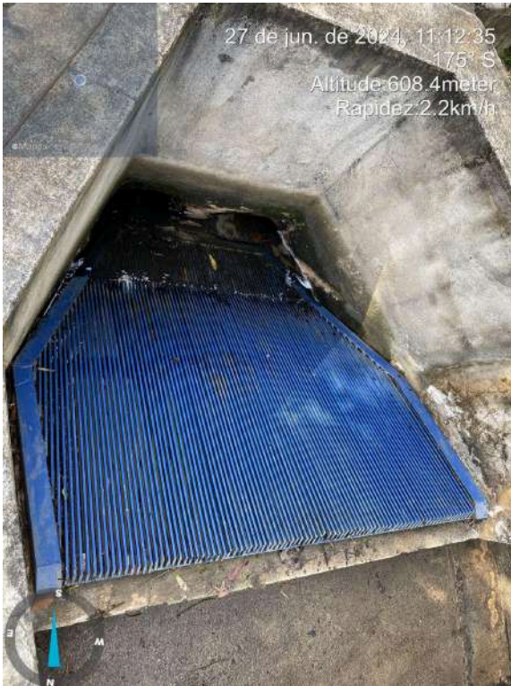
Figura 80: Sistema de tratamento d'água (gradeamento).
