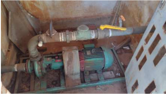
Figura 69: Bomba de abastecimento.
