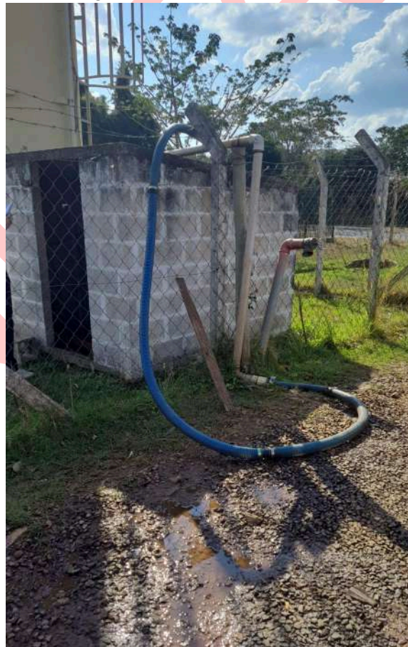
Figura 132: Casa de bomba.
