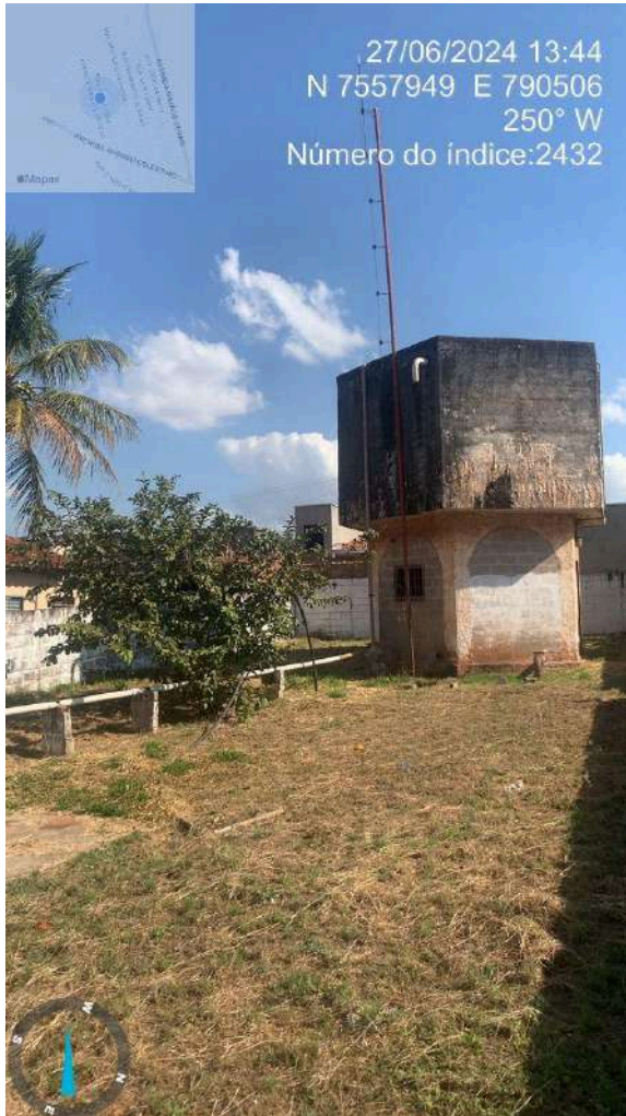
Figura 115: Poço (P9) Reservatório (R10).
