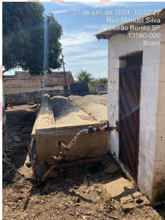
Figura 64: Casa de bombeamento.
