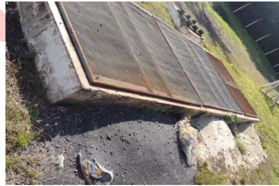
Figura 83: Sistema de tratamento d'água (Filtração).
